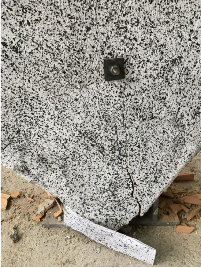
Resim 5.8. Diagonal yüklemeye maruz kalan duvarın ön yüzünde oluşan kılcal çatlaklar
