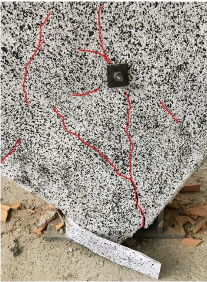
Resim 5.9. 'Resim 5.8'de gözlemlenen kılcal çatlakların işaretlenmiş durumu
