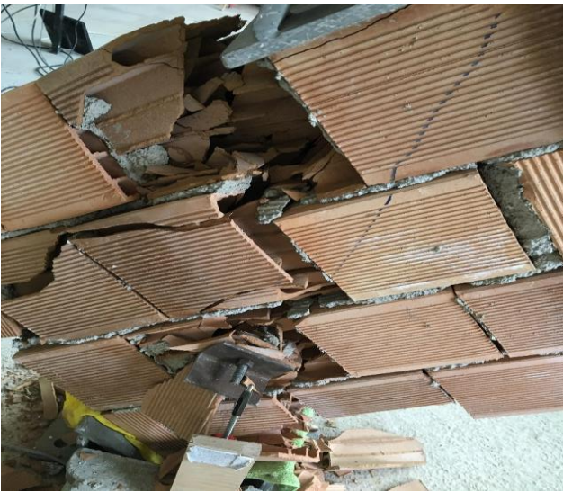
Resim 5.28. b) Diyagonal yükleme deneyi sonrası tek yüzü Tür 2 ile güçlendirilmiş 2. Tuğla duvar numunesinin arka yüzünde oluşan hasarlar
