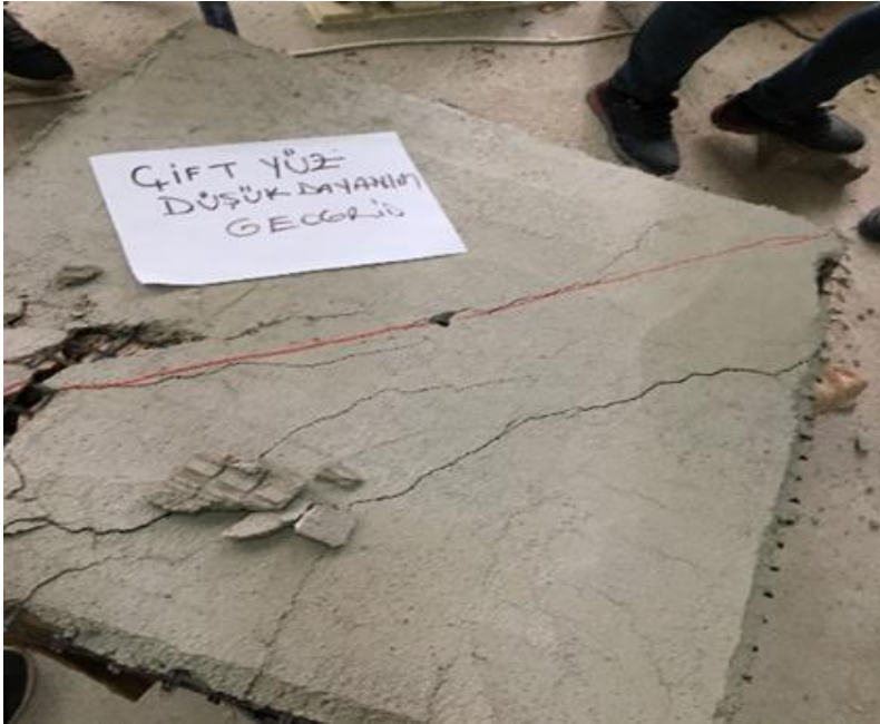
Resim 5.42. c) Diyagonal yüklemeye sonrası çift yüzü Tür 1 ile güçlendirilmiş 2. tuğla duvar numunesi
