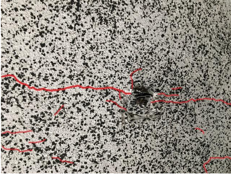
Resim 5.33. Diyagonal yükleme deneyi sonrası çift yüzü Tür 1 ile güçlendirilmiş 1. tuğla duvar numunesinin ön yüzünde oluşan kılcal çatlaklar
