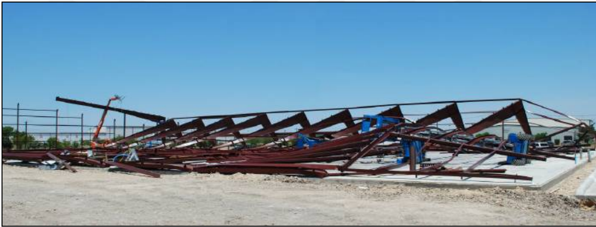
Şekil 2.5. ABD, Teksas'taki tek katlı depo inşaatının göçmeden sonraki durumu
