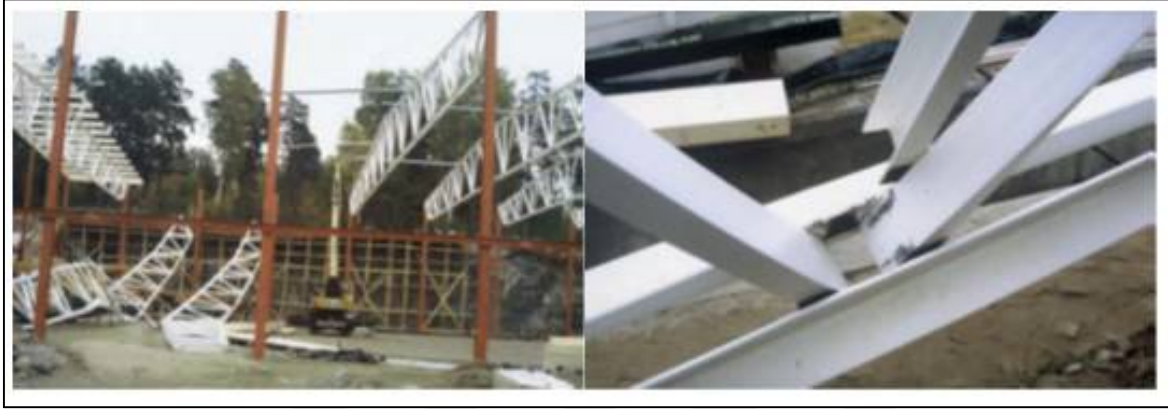
Şekil 2.3. İsveç'teki spor salonu çatısının göçmesi sonrası
