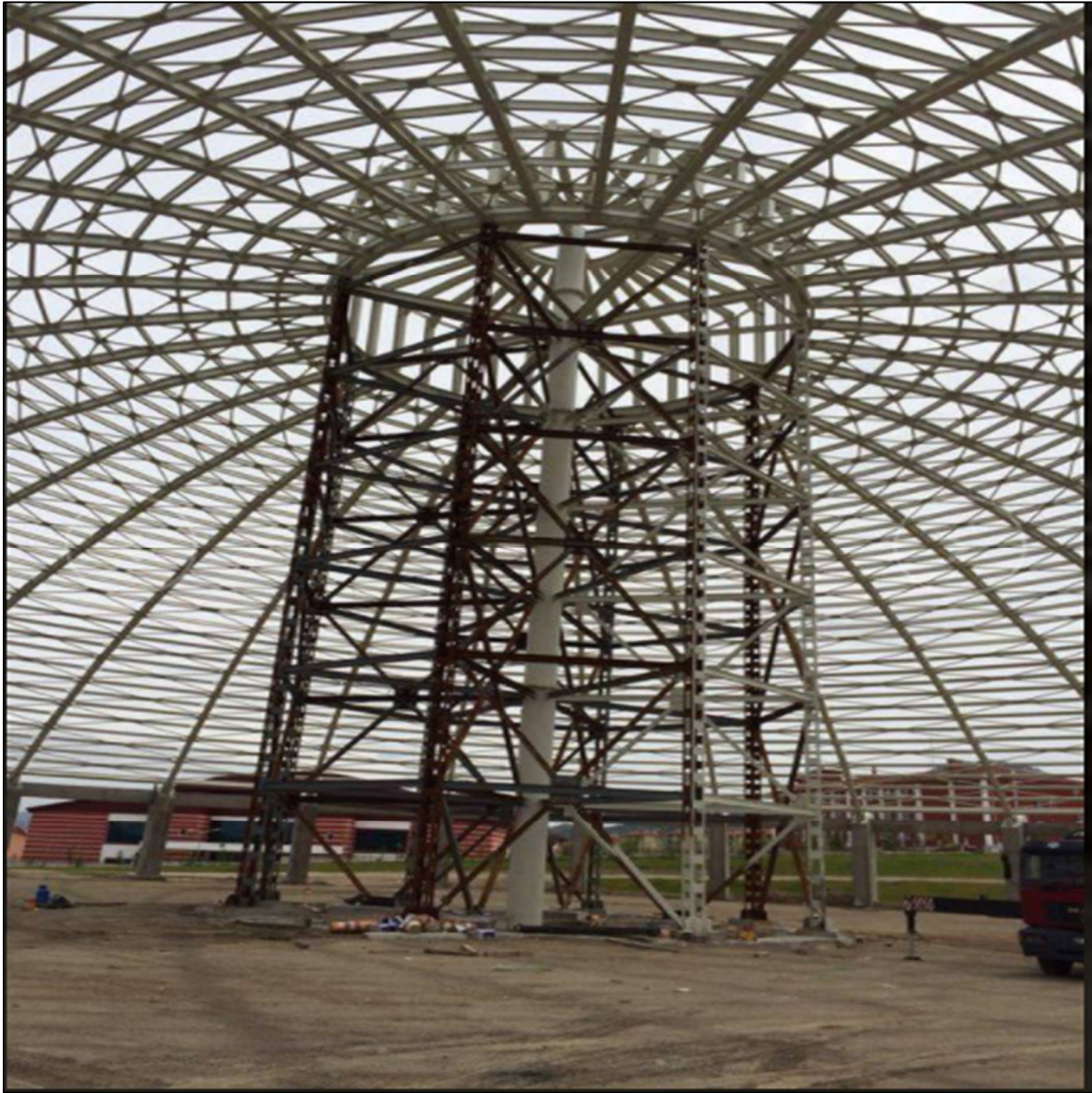
Şekil 4.6. Sonradan tamamlanan yapıda iskele farkı ve çaprazların görüntüsü
