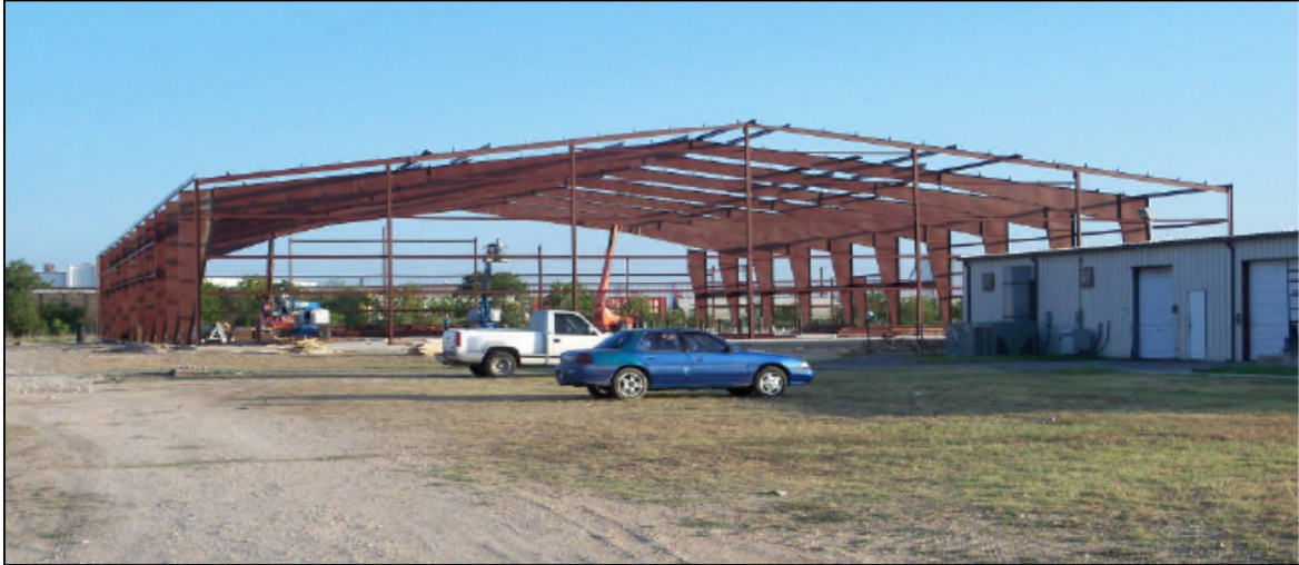
Şekil 2.4. ABD, Teksas'taki tek katlı depo inşaatının göçmeden önceki durumu
