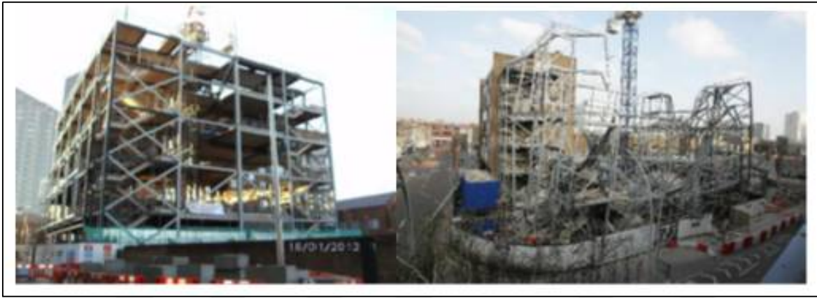
Şekil 2.7. UK, Ilford'daki kilise binasının göçme öncesi ve sonrası
