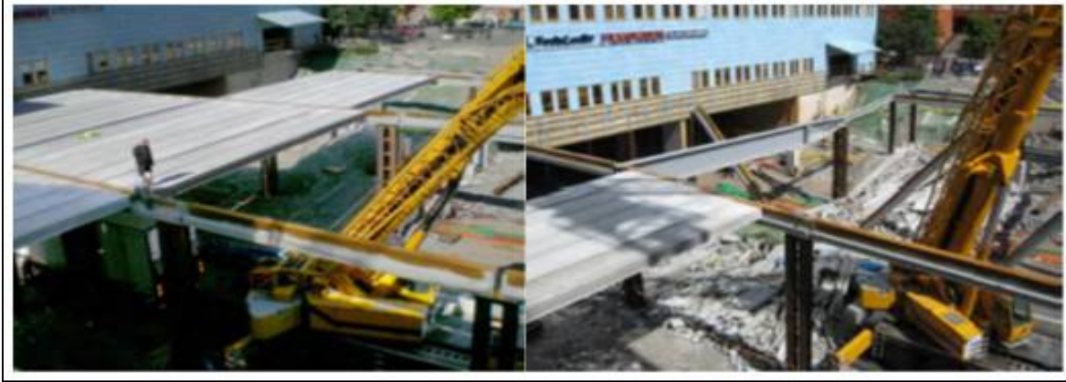
Şekil 2.1. İsveç, Stockholm'deki ticaret merkezi inşaatının göçme öncesi ve sonrası
