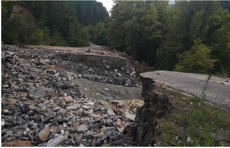
Resim 2.2. Sinop sel afeti sonrası yaşanan heyelan kaynaklı karayolu hasarı
