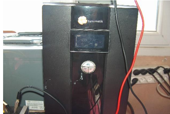
Şekil 7. 3kVA gücünde İvertör
