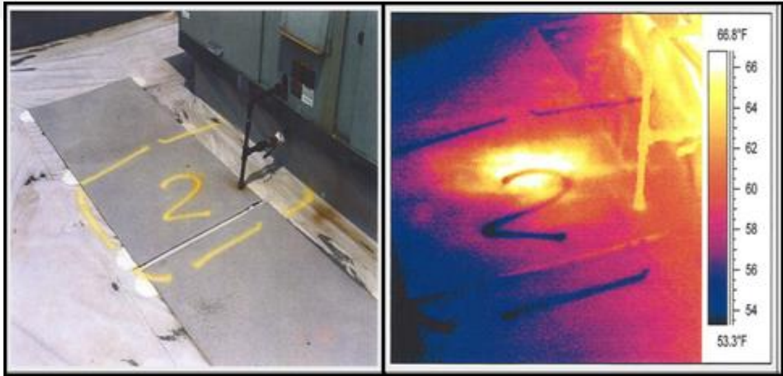
Şekil 2.3.Çatı zarında meydana gelen nemin termal ve gerçek görüntüsü (Kominsky, 2005)
