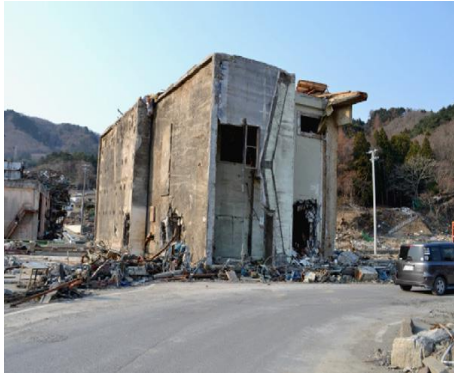
Resim 5.1. Yanal yükler nedeniyle yapının devrilmesi [37]
