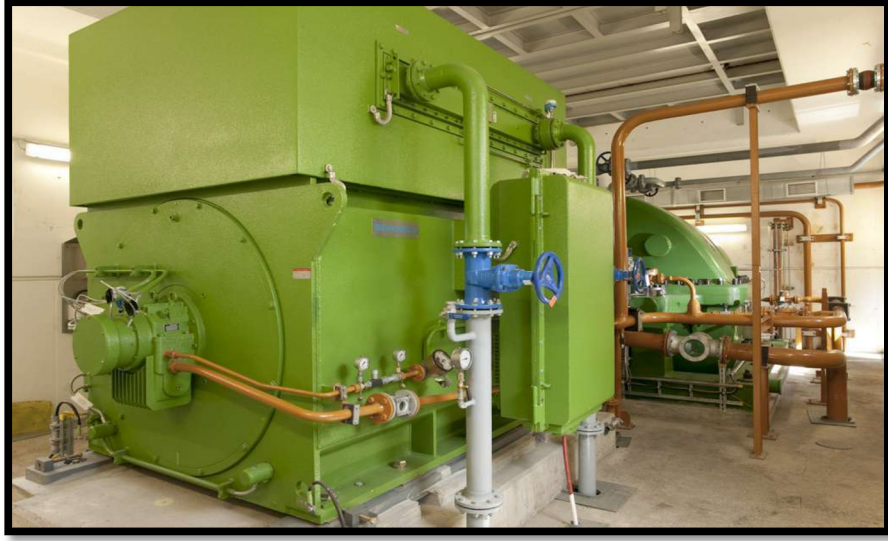
Şekil 3.15. TBT ünitesi jeneratörü (Anonim, 2015b)
