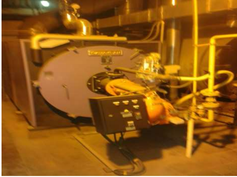
Şekil 3.8 Mevcut sıcak su kazanı
